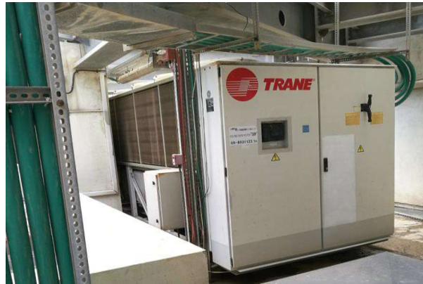
Kältemaschine auf dem Dach
